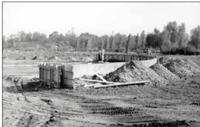
Výstavba Památníku sovětských vojáků, srpen 1976. Construction of the Memorial to Soviet Soldiers, August 1976.
