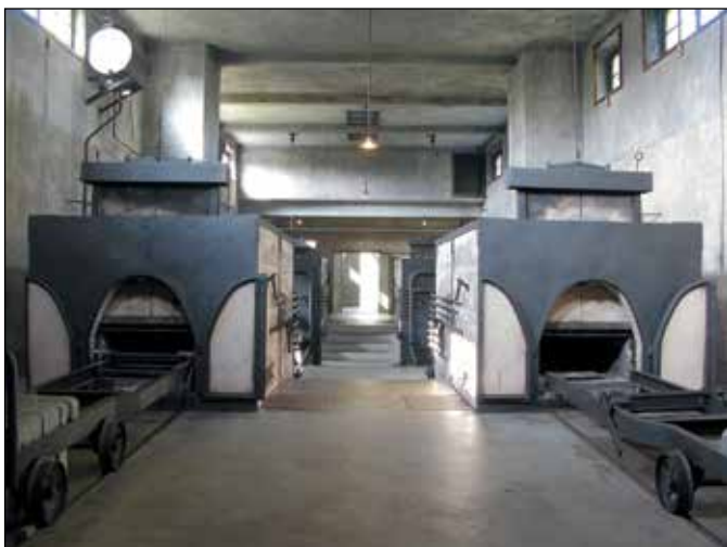
Pece v krematoriu na Židovském hřbitově. Furnaces in the Crematorium in the Jewish Cemetery.
