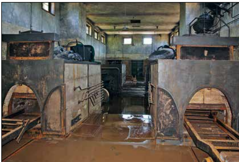
Vnitřek krematoria postižený povodní
